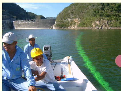
Deteccão de escapamento nas represas (Honduras)
